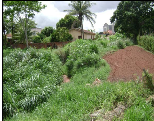
Foto 27. Erosão com aproximadamente 300m de extensão
