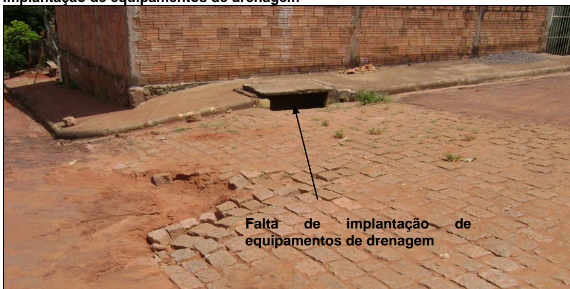
Foto 13. Boca de lobo aberta podendo causar acidentes aos moradores e sem implantação de equipamentos de drenagem
