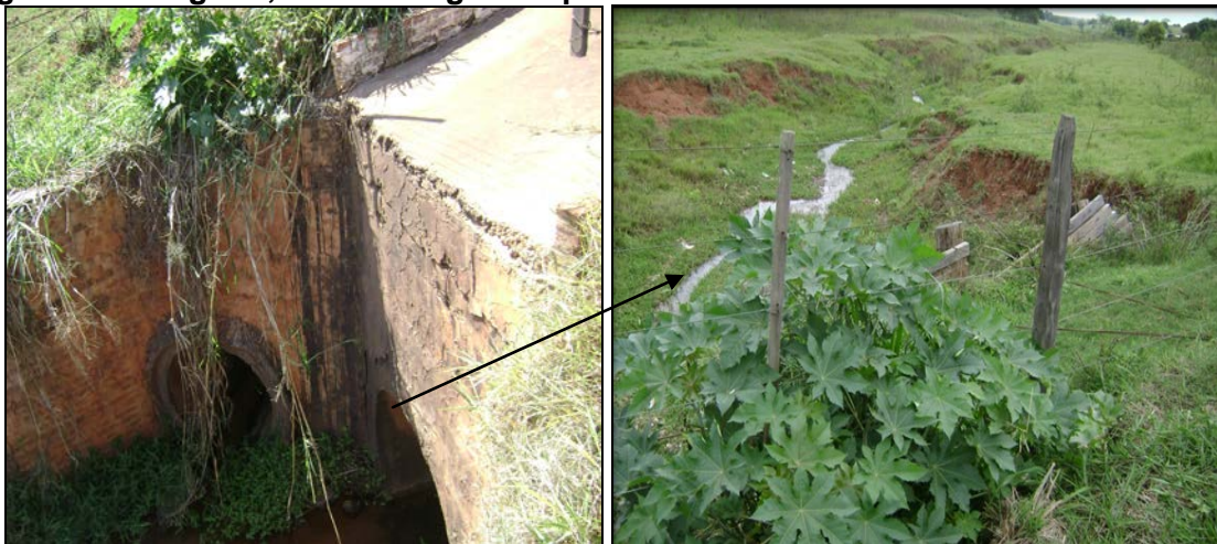
Fotos 15 e 16. Saída da água pluvial coletada da via de acesso da cidade pela galeria retangular, causando grande processo erosivo
