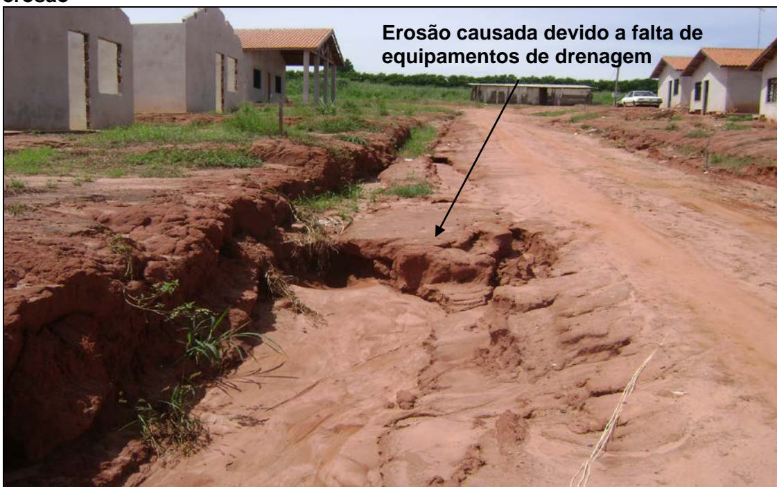
Foto 2. Rua sem pavimentação sem equipamentos de drenagem causando erosão
