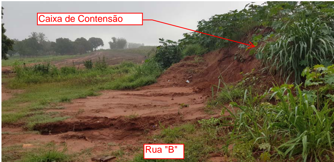
Lado externo da caixa de contenção da Rua "B" sofrendo erosões e colocando em risco a área rural.
