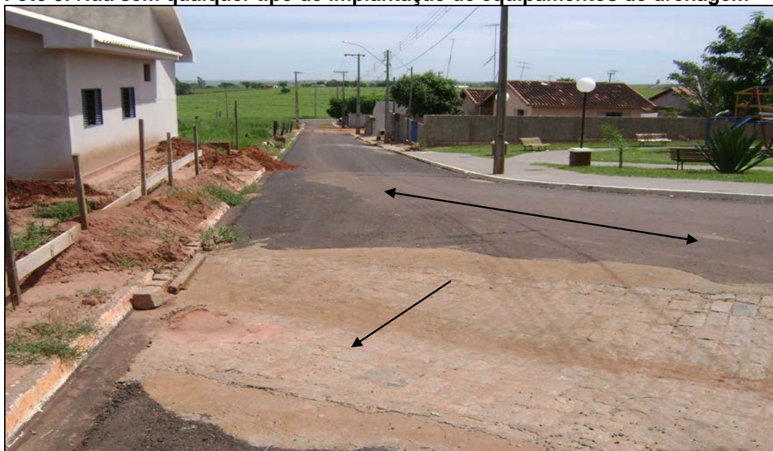
Foto 9. Rua sem qualquer tipo de implantação de equipamentos de drenagem
