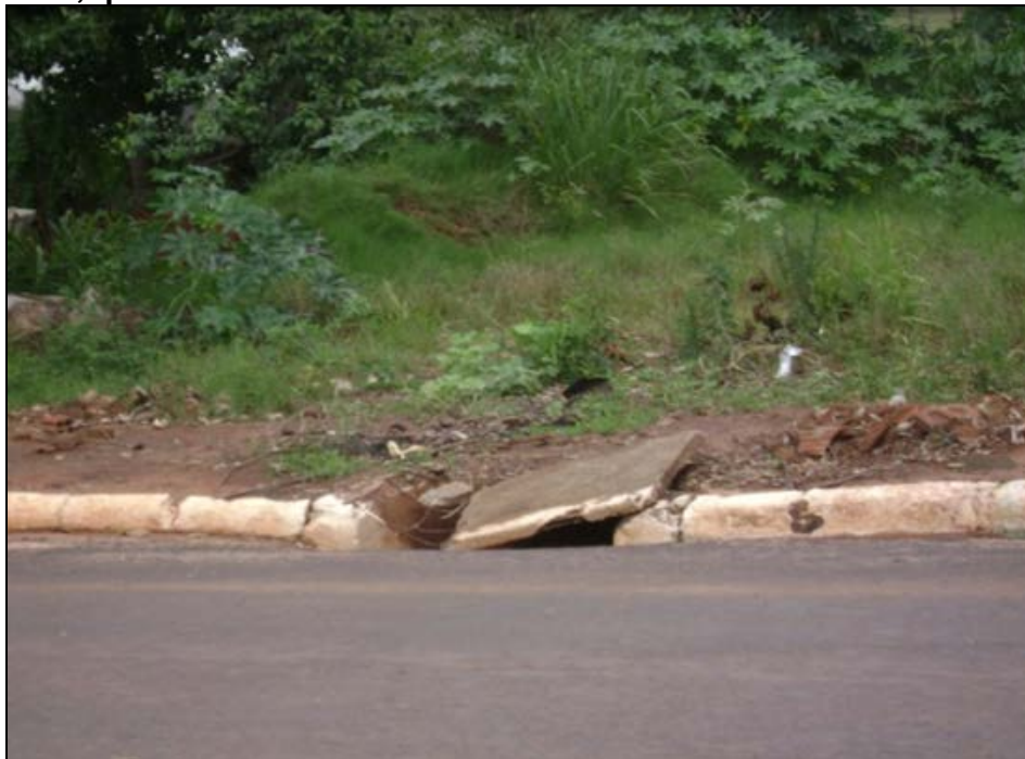
Foto 25. Único ponto de lançamento de águas pluviais no prolongamento da rua Projetada 2, quando a mesma cruza com a rua Manoel Sanches Parra
