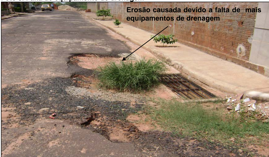
Foto 3. Falta de equipamento de drenagem
