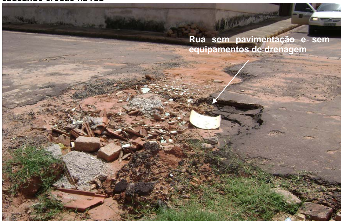
Foto 5. Asfalto deteriorado devido à falta de equipamento de drenagem causando erosão na rua
