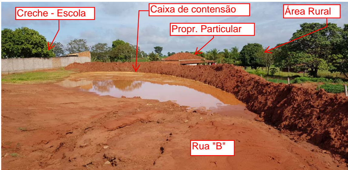
Caixa de contenção na Rua "B".
