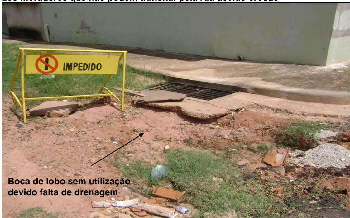
Foto 6. Falta de equipamentos de drenagem, causando forte erosão e transtorno aos moradores que não podem transitar pela rua devido erosão
