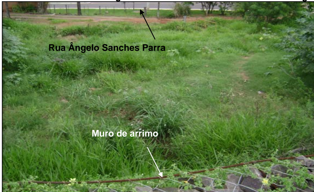
Fotos 19 e 20. Vista da Rua Ângelo Sanches Parra e o muro de arrimo de gabiões
