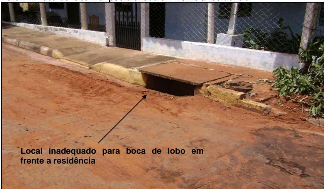
Foto 11. Boca de lobo mal posicionada em frente à residência
