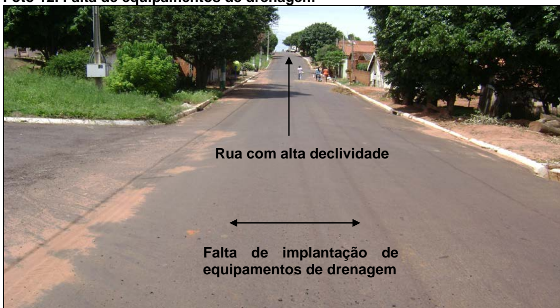
Foto 12. Falta de equipamentos de drenagem
