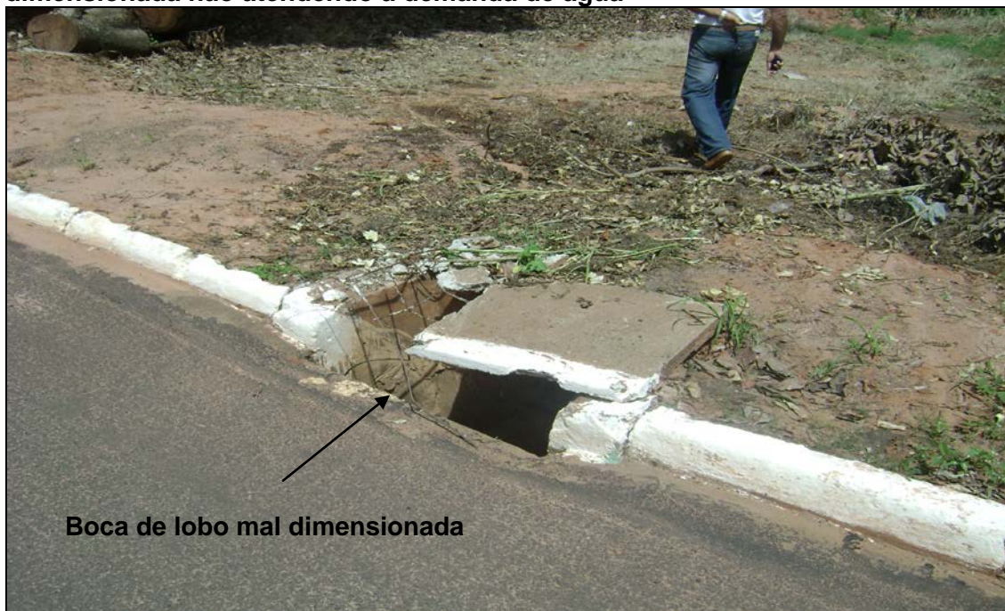
Foto 1. Boca de lobo aberta podendo causar acidentes aos moradores, mal dimensionada não atendendo a demanda de água
