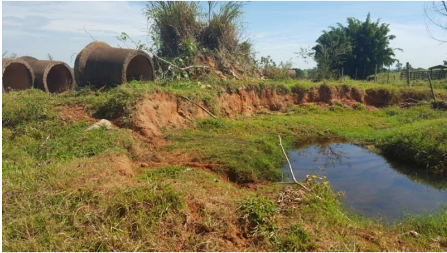
Foto 3.5 – Erosão no final da Rua Projetada 2
