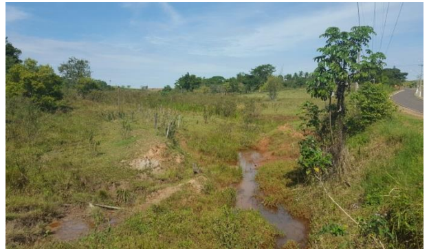
Foto 3.6 – Erosão no final da Rua Projetada 2
