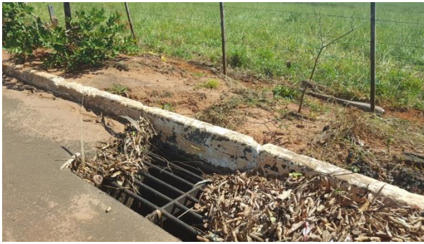
Foto 3.3 – Estrutura de microdrenagem com necessidade de limpeza
