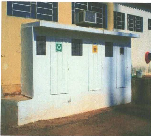
Foto: a - Abrigo para o acondicionamento dos Resíduos Infectantes, recicláveis e orgânicos instalado na Unidade Básica de Saúde Municipal
